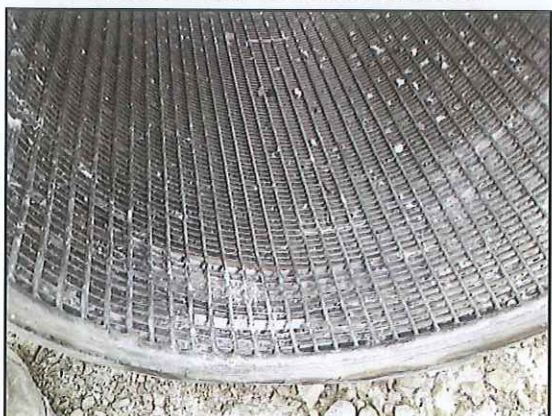
Tube crépiné endommagé, avant réparation
