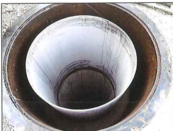
Tête du forage avant fermeture
