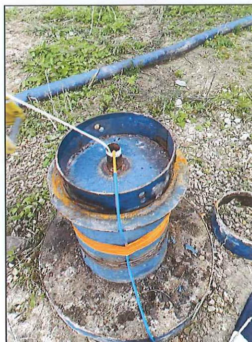
Tête étanche sur le piézomètre pendant l'acidification
