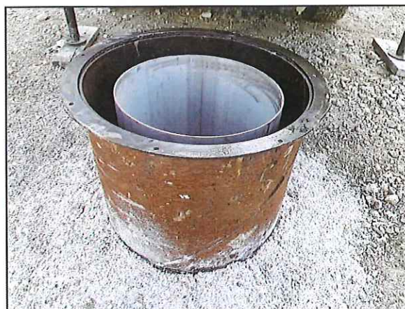
Tête du forage avant fermeture
